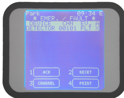
Figura 23) Videata in stato di Guasto
