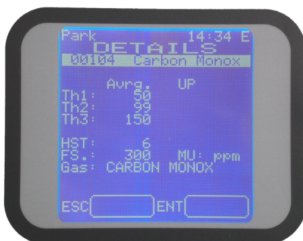
Figura 42) Dettagli configurazione rilevatore gas
